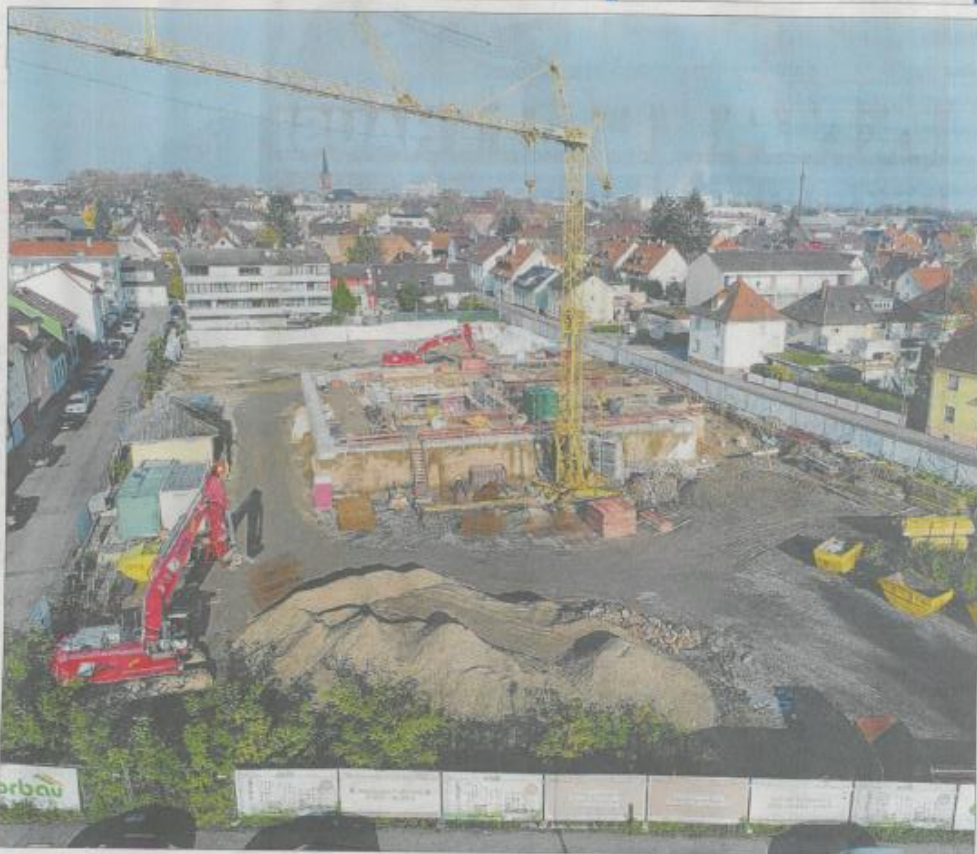
Das Unternehmen Orbau gibt einen Zwischenbericht über den aktuellen Stand der Bauarbeiten auf dem Oase-Areal an der Ecke Bierkeller-/Kanzmattstraße. Foto: Orbau-Projektgesellschaft Zollburg mbH
